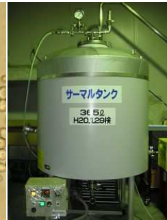
耐圧サーマル タンク
